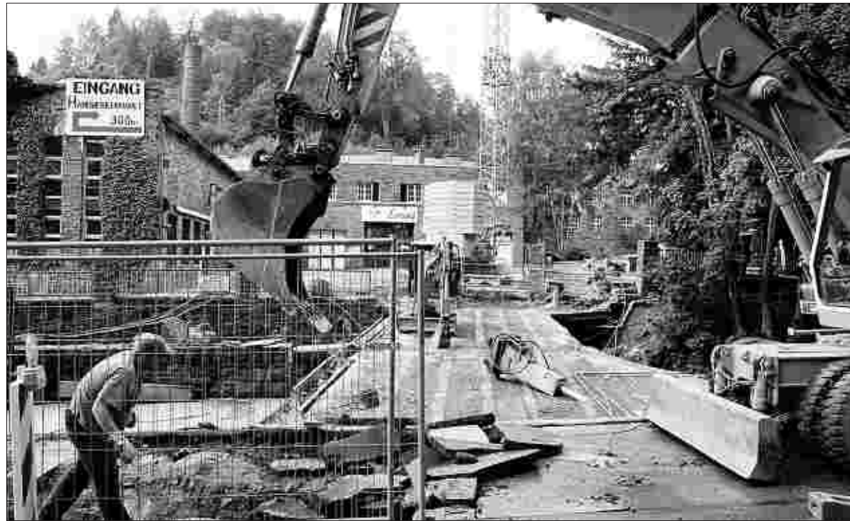
Ein Sanierungsfall für einige Monate: Die zum Handwerkerdorf Monschau führende Brücke über die Rur muss komplett erneuert werden. Foto: P. Stollenwerk
